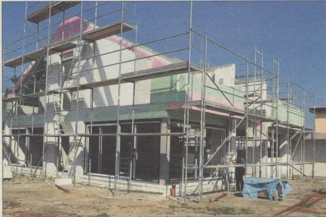
Horrorszenario: Wände stürzen ein und die verantwortliche Firma ist schlagartig pleite – dagegen hilft nur die Bauherrenversicherung.
